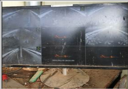
CCTV 고장 방치
